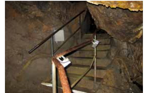
Svítidla firmy Cave Lighting nainstalovaná na zkorodovaném zábradlí v jeskyni Grottes de Han.
