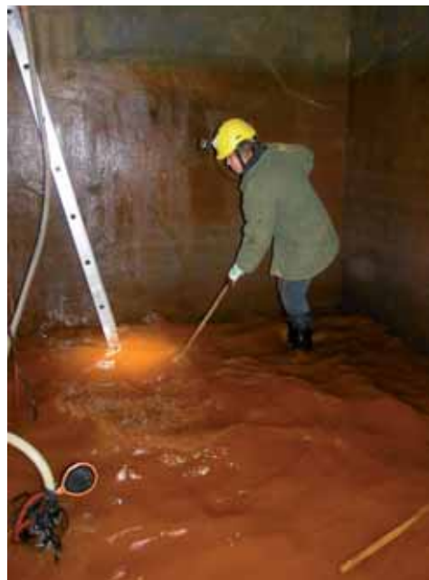
Kateřina Svobodová při pravidelném čištění rezavých usazenin v koněpruském vodojemu pod vrcholem Zlatého koně.
