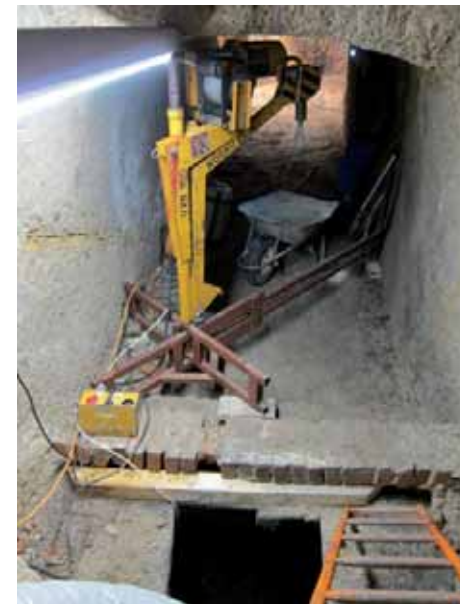
Těžební zařízení instalované nad ústím studny ve třetím podlaží sklepních prostor.
