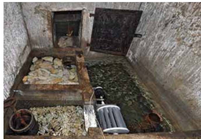
Celkový pohled na interiér jímacího objektu, regulační komory byly vybudovány v r. 1930. V pozadí průlez do původní části z 19. století. Foto: Josef Vandělík, SJ ČR
