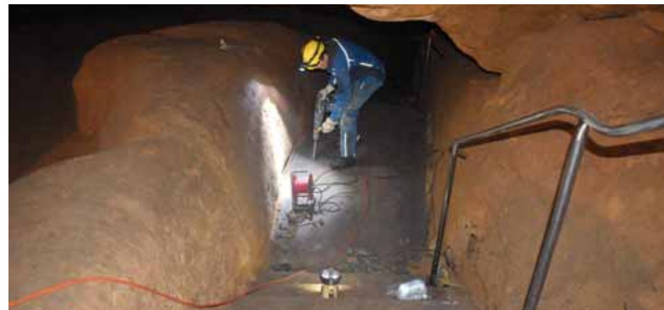
Tomáš Zdílna otvírá prastaré kabelové zlábký. Tak to dopadá, když se víčko připevní cementem.
