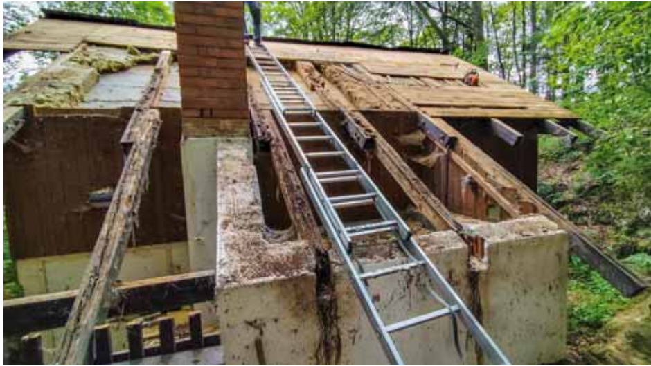
Hrůzný stav nosných konstrukcí po odkrytí střešní krytiny. Foto: Dušan Milka, SJ ČR
