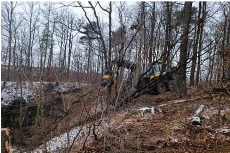
Odstraněné zábradlí na sv. okraji Propasti umožnilo harvestoru dostat se až téměř na hranu skalní stěny.
