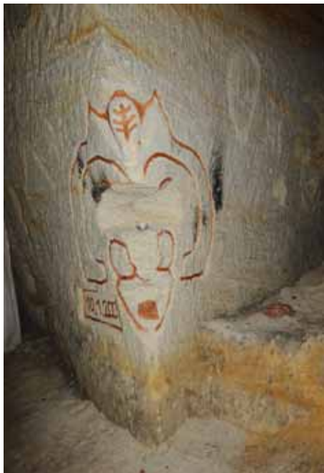
Poškozené hrany piliřů dnes významně ohrožují stabilitu chodeb kaolínového dolu. Foto: František Krejča, SJ ČR
